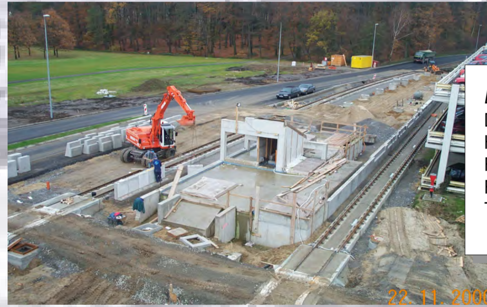
Die Fertigteile für den Bahnsteig und der Tragrahmen für die Fahrtreppen werden errichtet
